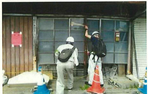
写真 建物被害認定調査の支援
