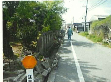
写真 先遣隊の被害状況調査(熊本市南区)
