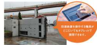
《防潮鉄扉の遠隔操作化》
