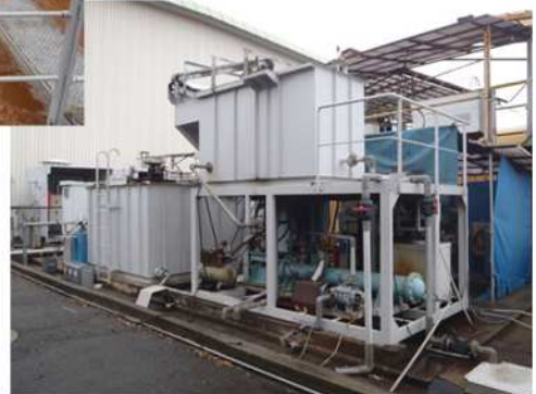
凝集加圧浮上
