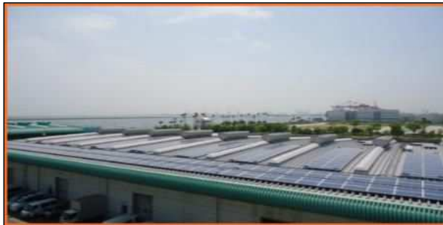
図 19 臨海部の屋根上太陽光発電設備
