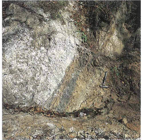
五助橋断層の断層破碎帯
