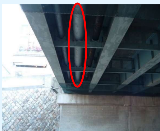
水管橋の上部は通常目視できない ×
