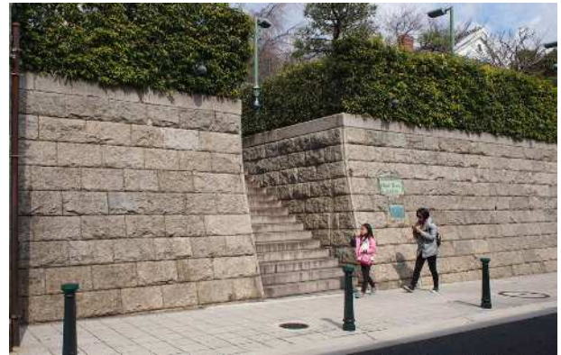
石積みの擁壁が圧迫感をやわらげ、伝統的な景観を守っています
