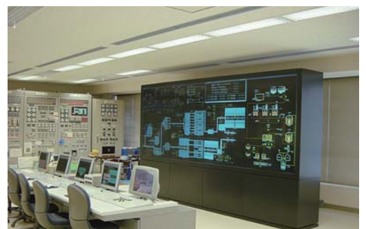
西部処理場中央監視室
