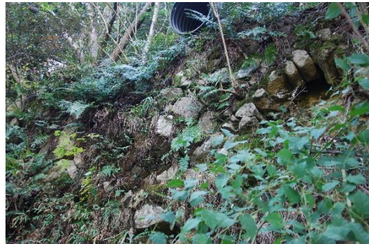
写真：③西側石垣（一部崩壊）
