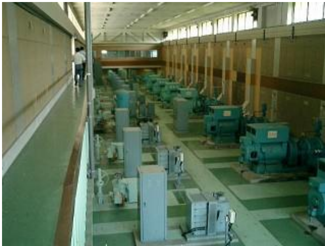
(千苺浄水場のポンプ室)
