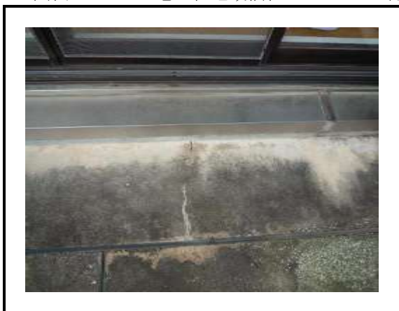
<図表3-119> 竜が台地域福祉センターの外壁の損傷の状況
