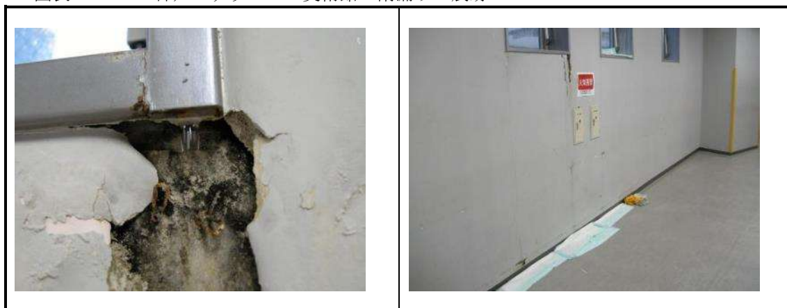
<図表3-140> 神戸ファッション美術館の雨漏りの痕跡
