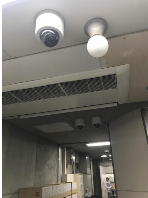
券売機室の監視カメラ
