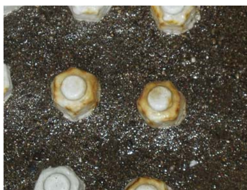
ナットやボルトに錆が生じた状況
