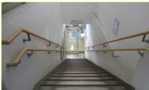
施設内のバリアフリー対応ができていない
