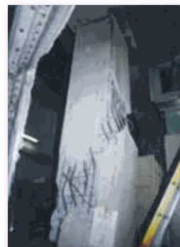
三宮駅構内の被災状況と復旧工事
