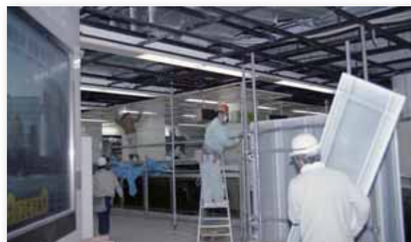
三宮駅構内の被災状況と復旧工事
