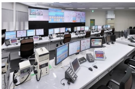
消防管制室の状況
