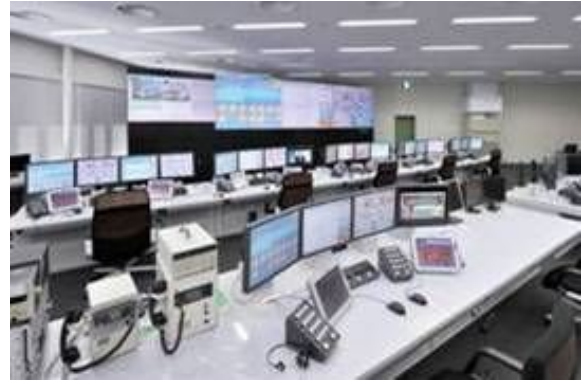
消防管制システム
