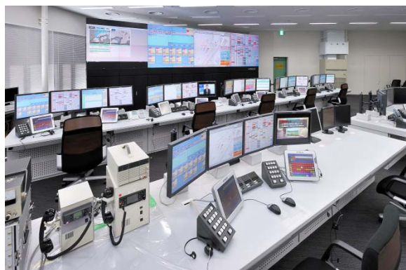
消防管制室の状況
