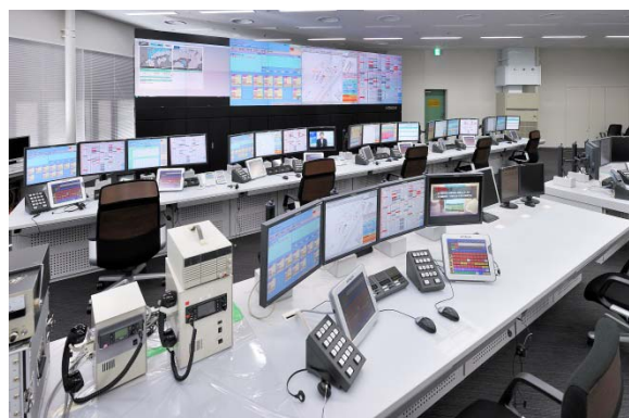
消防管制室の状況
