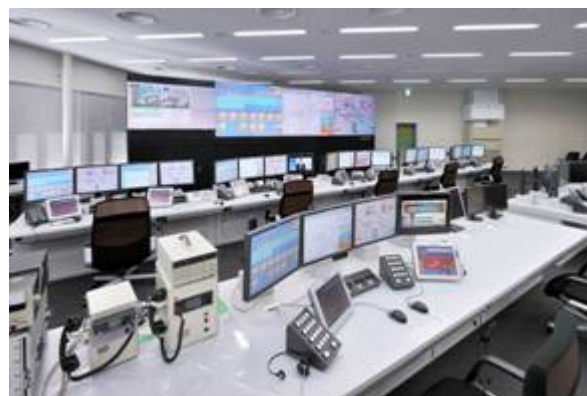
消防管制室の状況
