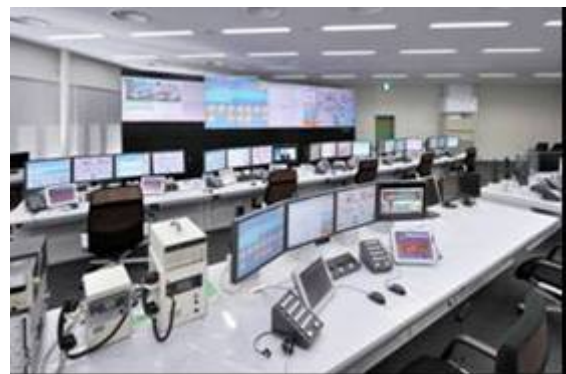
消防新管制システム(ALT-FACE)
