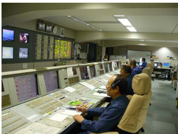
消防管制室の状況
