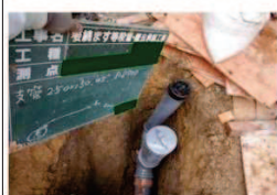
③ 接続状況
