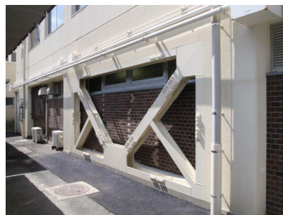
写真 施設の耐震補強策(ブレース)
