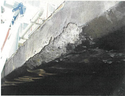
躯体コンクリート劣化による損傷 (処理場内の水路 コンクリート剥離)
