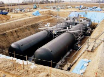
大容量貯水槽
