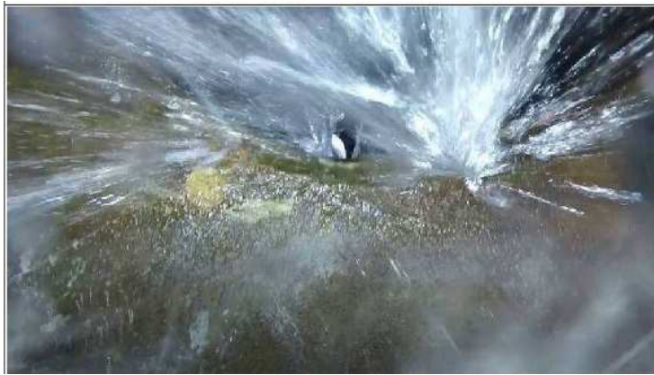
浮流式テレビカメラ写真 浸入水 (D)Aランク 吹き出ている
