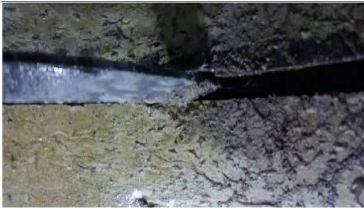
浮流式テレビカメラ写真 パッキン異状 (P)Bランク ゴム輪の露出あり
