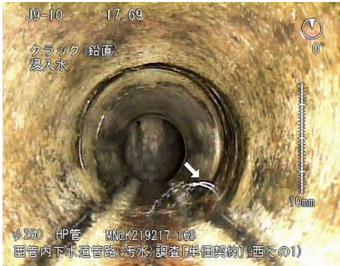
自走式テレビカメラ写真 浸入水 (D)Aランク
